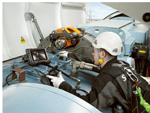
Рис. 1: Осмотр внутренней полости редуктора
